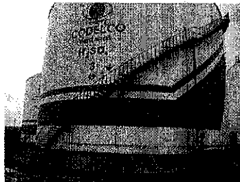
4 Estanque almacenamiento ácido
