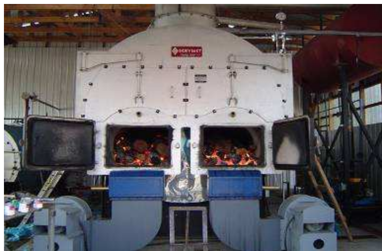
FIGURA 3.8-7. CALDERA SV-VL 1500 EN FUNCIONAMIENTO
