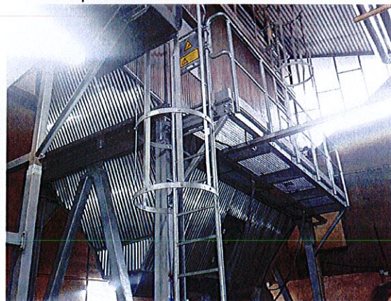
Foto2: Precipitador electrostático Scheuch de 2 campos de la caldera BINDER a biomasa
