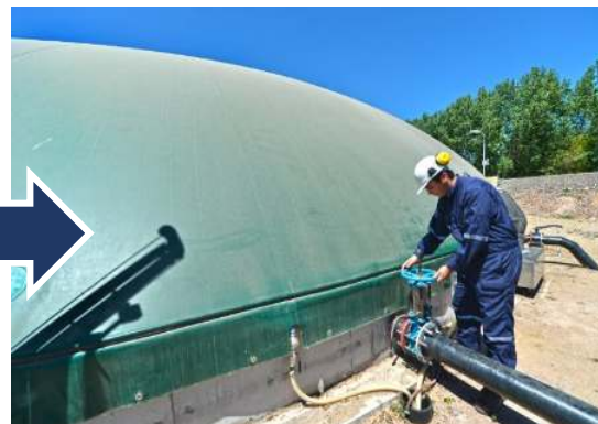
Biodigestor Plantel porcino Las Pampas. Pichidegua VI región
