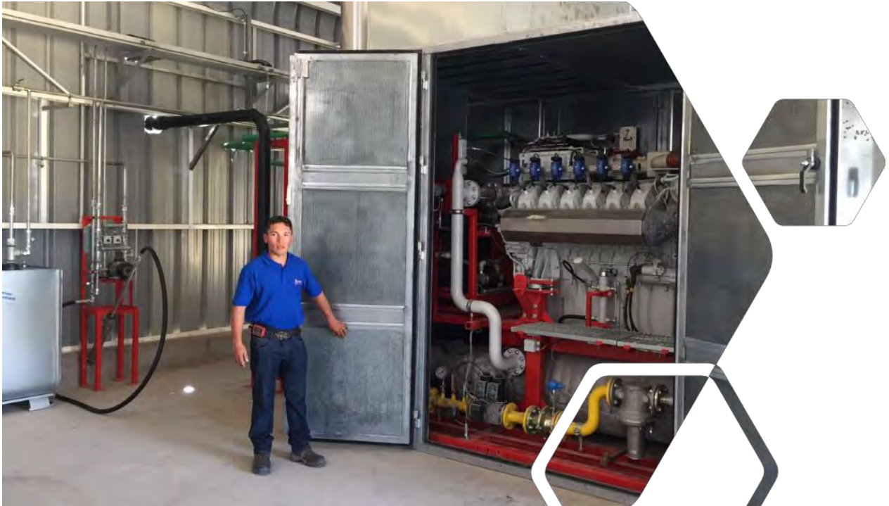
Imagen interior de generador de 529 kW junto a nuestro operador Juan Veliz.
