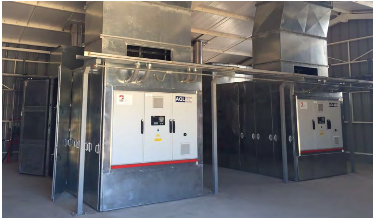
Imagen de Cogeneradores a Biogás (529 kW c/u) de AASA Energía en Plantel Campesino
