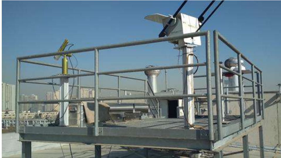
Figura 1.17: Plataforma azotea del Departamento de Matemática y Ciencia de la Computación, donde se observa instalado el emisor del DOAS.
