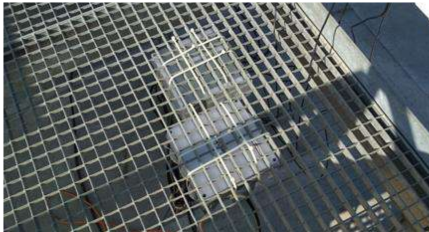
Figura 1.18: Cajas de protección eléctrica, vista desde arriba.
