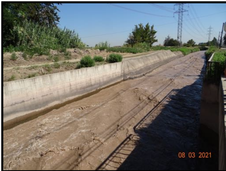
Figura 7. Canal de La Luz, PTAP La Florida.
