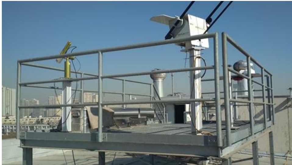
Figura 1.17: Plataforma azotea del Departamento de Matemática y Ciencia de la Computación, donde se observa instalado el emisor del DOAS.
