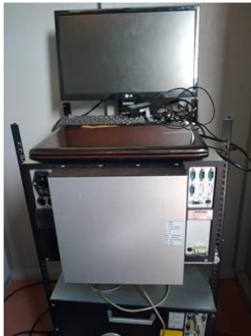
Figura 1.10: Rack con computadores y componentes electrónicos en el interior de la caseta.
