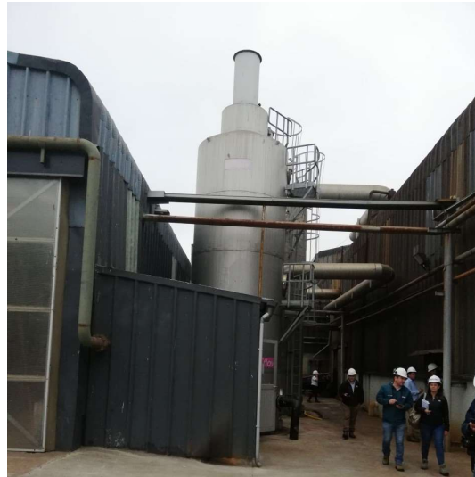
Scrubbers (Químico /Ozono)
