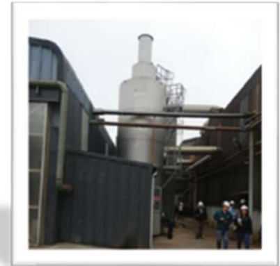
Scrubber (Químico /Ozono)
