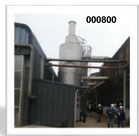
Scrubber (Químico /Ozono)
