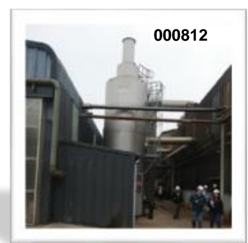
Scrubber (Químico /Ozono)
