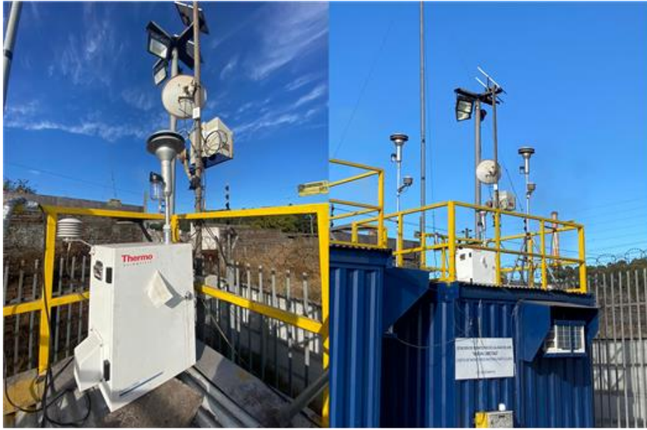
Figura 7-8 Muestreador MP 10 en estación Nueva Libertad, Talcahuano
