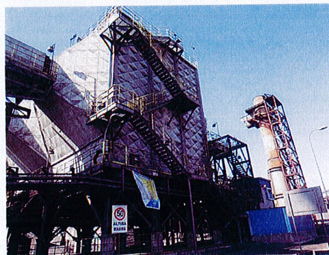
Ilustración: Precipitador electrostático en Chimenea 2A; al fondo se ve la chimenea 2B
