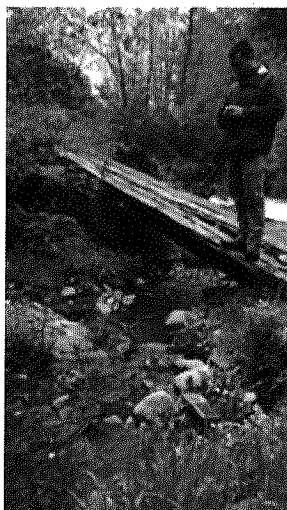
Ducto 2 Termas Los Pozones
