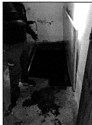
Ducto 2 Termas de Palguín
