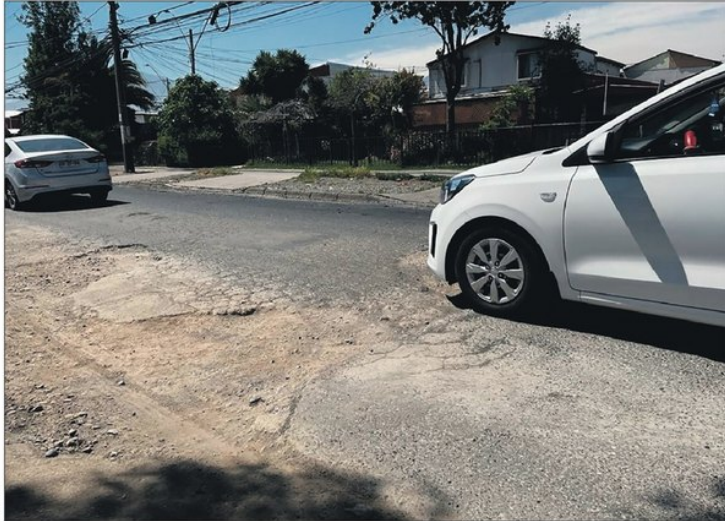
Este asfalto deteriorado, en Puente Alto, puede convertirse en hoyo.
